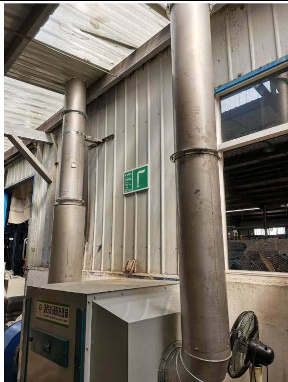
废气处理设施
